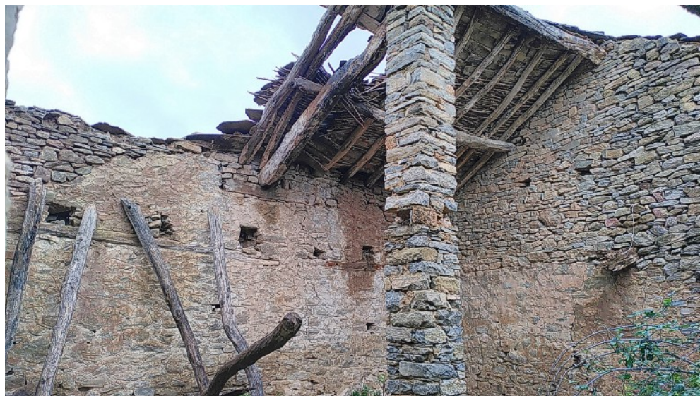
Les dégradations se poursuivent (la toiture était complète en 2019)
